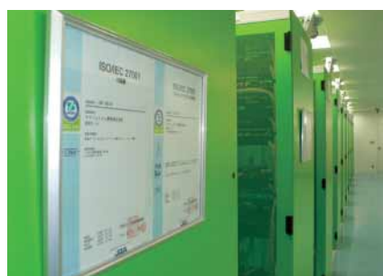
ヤマトシステム開発(株)のサーバールーム
