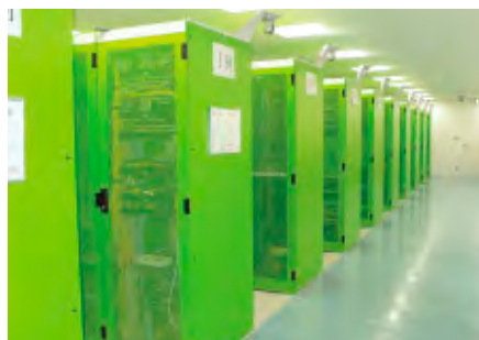
情報セキュリティが確保されたサーバールーム（ヤマトシステム開発(株)）
