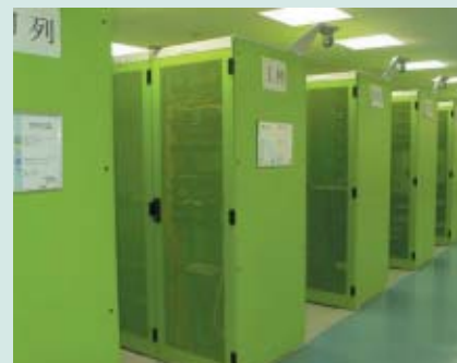
サーバールーム
