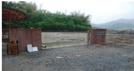
(被災した竹駒保育園の門柱)
