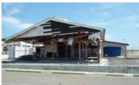
（被災直後の道の駅よつくら港交流館）
