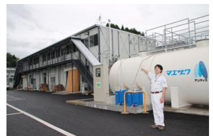
施設設備例／ 加工団地の排水処理施設 50トン／日の処理能力を持つ
