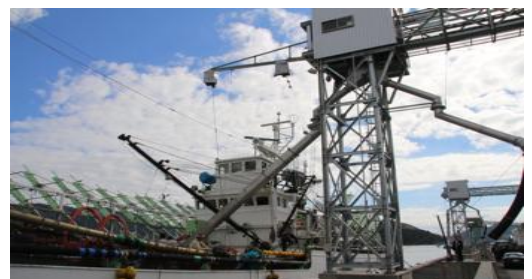
貯氷施設からコンピュータ制御で直接漁船へ氷を供給
